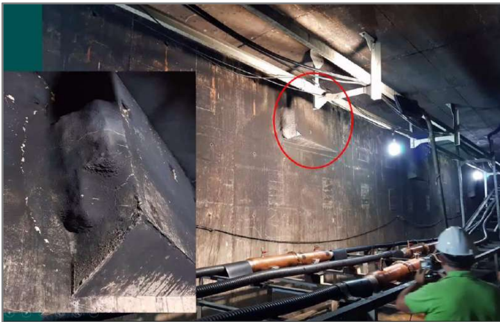
Imagen N° 37. Anclaje del Cable de Postensado del PGRU
