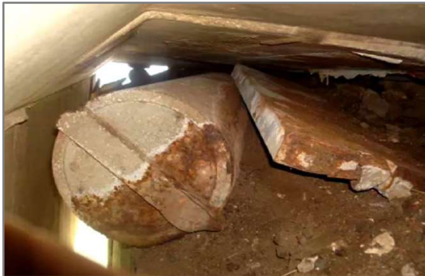
Imagen N° 36. Falla en Apoyo Móvil de la Pila N° 27 del PGRU
