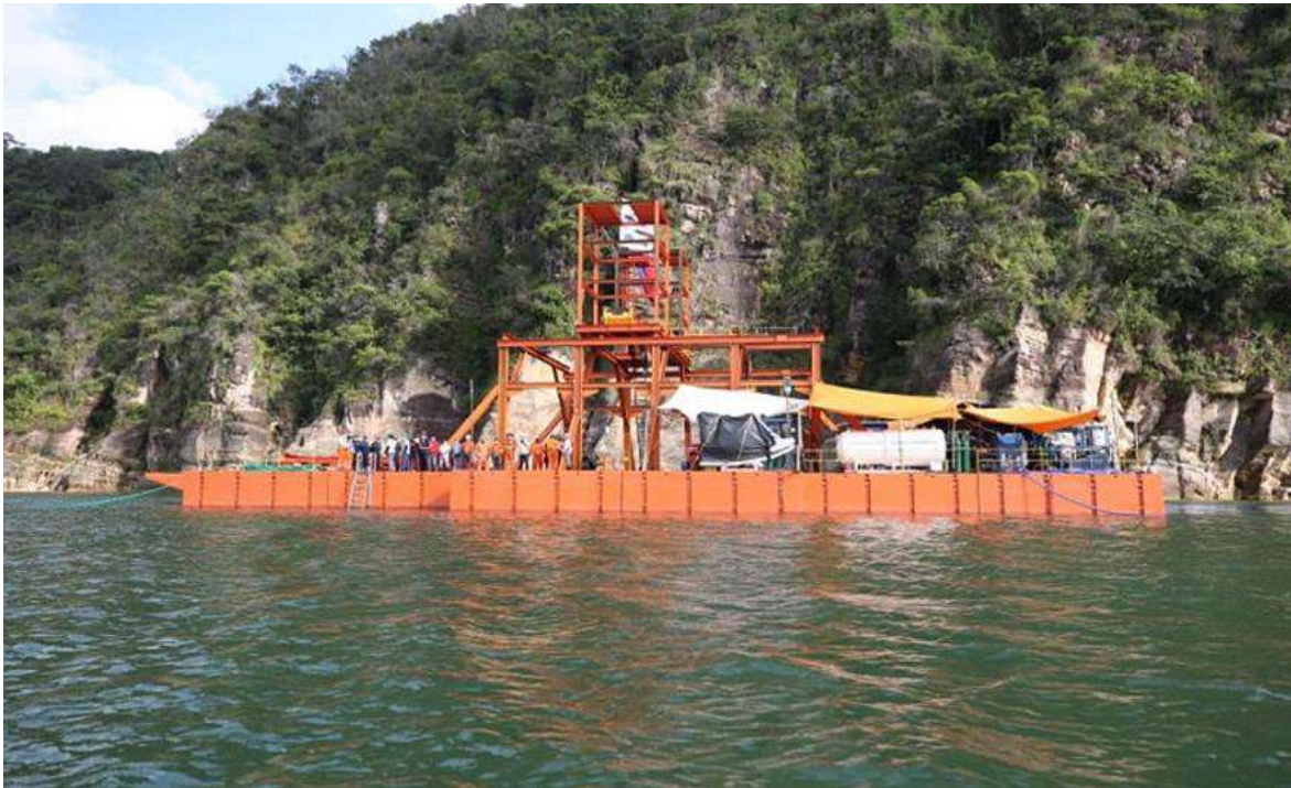
Imagen N° 8. Gabarra de apoyo para corregir la fuga
