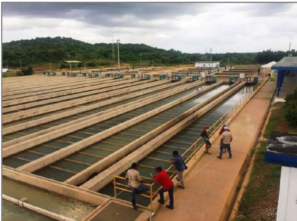
Imagen N° 22. Planta Potabilizadora Wüimpala
