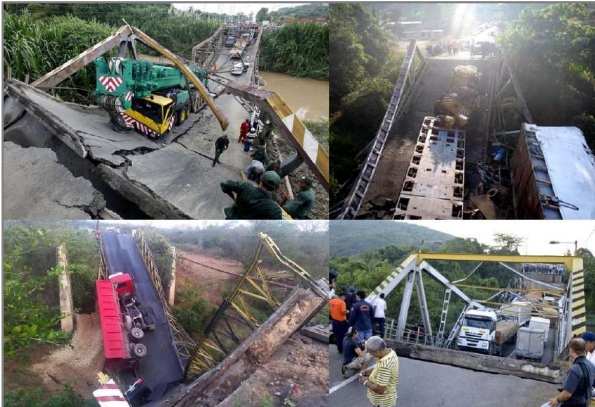
Imagen N° 31. Colapso de los puentes de Cúpira, Escalante, Yama y Boca de Uchire
